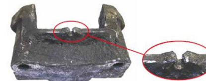
Aufnahme gebrochen / mounting broken
